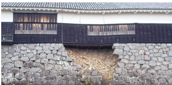
崩落した状態の石垣
