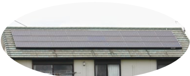
太陽光発電施設(住宅)
