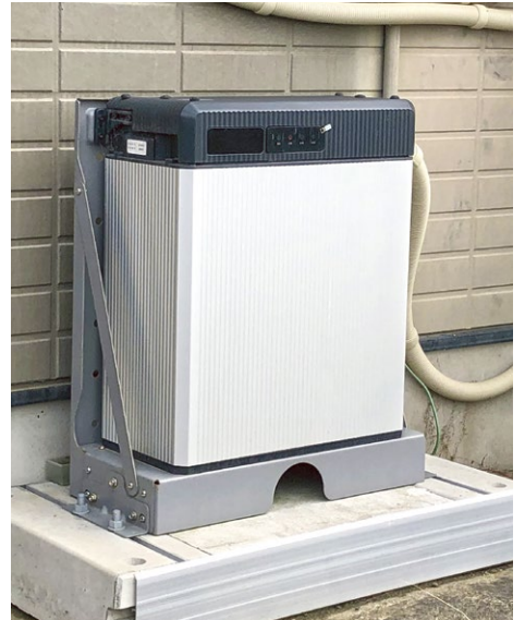
蓄電システム
