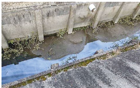
水路あぜ道の崩落箇所
